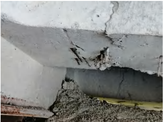
横隔板底面露筋
