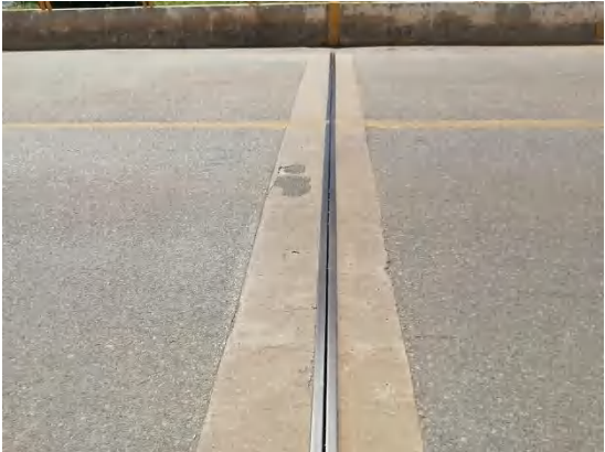
破损伸缩缝锚固砼横向裂缝
