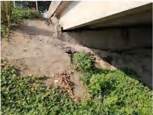
锥坡、护坡滋生杂植
