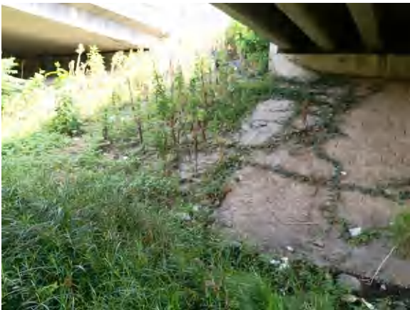
锥坡、护坡滋生杂植
