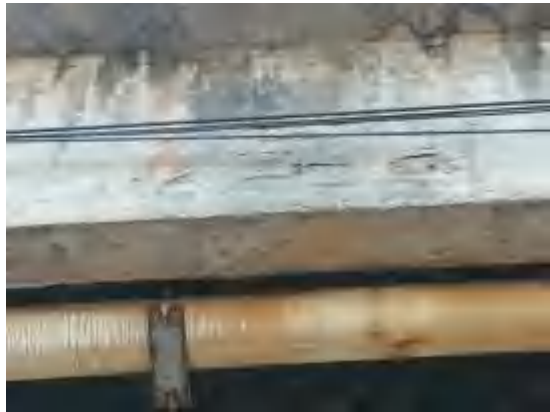
腹板锈胀砼剥落
