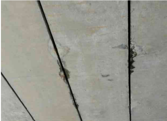
空心板底板破损
