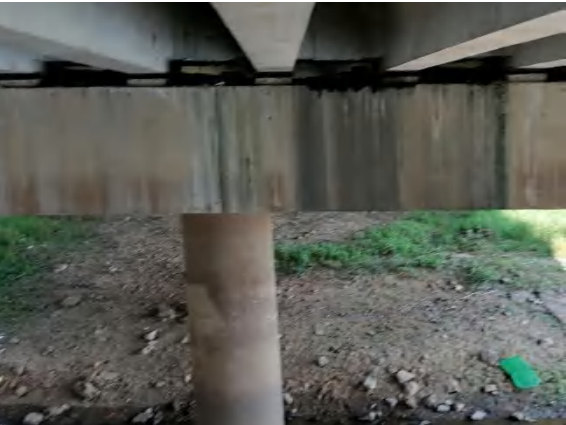
左幅 3#盖梁渗水污染
