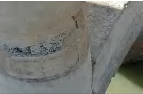
墩柱破损露筋
