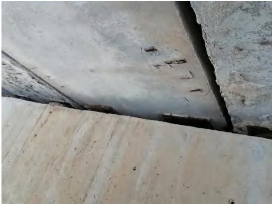
空心板底板锈胀
