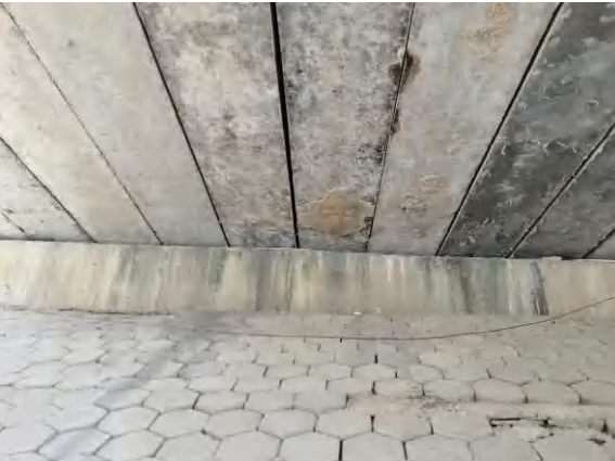
右幅 6#桥台盖梁渗水污染
