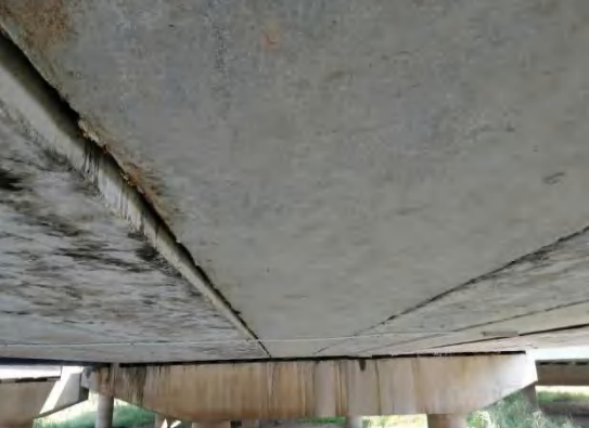
空心板底板纵向裂缝
