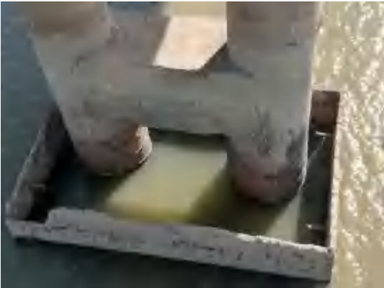
基础冲刷露骨
