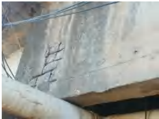
T 梁腹板锈胀露筋
