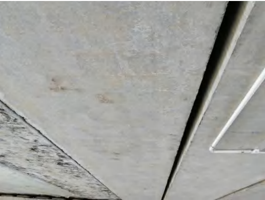
空心板底板纵向裂缝
