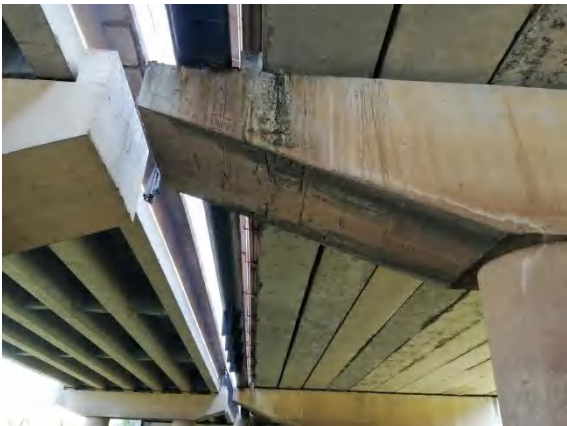
右中幅 4#盖梁右侧端部底面锈胀
