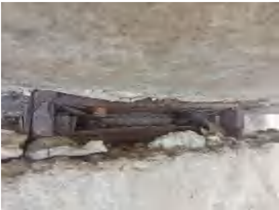
主桥盆式支座钢盆锈蚀裂缝
