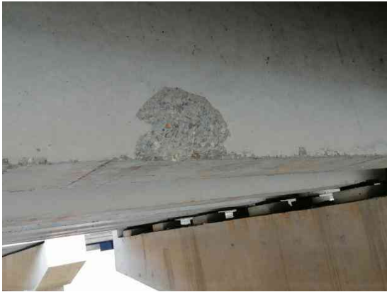
T 梁腹板混凝土剥落
