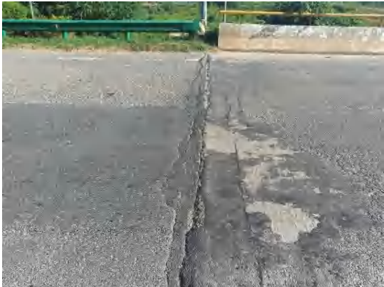
桥台位置路面破损
