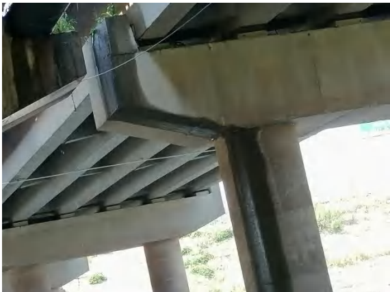
右中幅 3#盖梁右侧端部渗水污染
