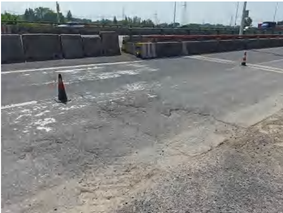
辅道桥 0#桥台搭板大面积破损、坑槽
