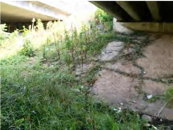
锥坡、护坡滋生杂植
