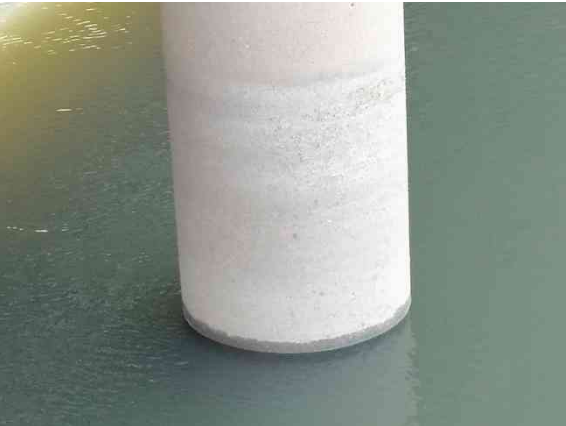
立柱冲刷、露骨
