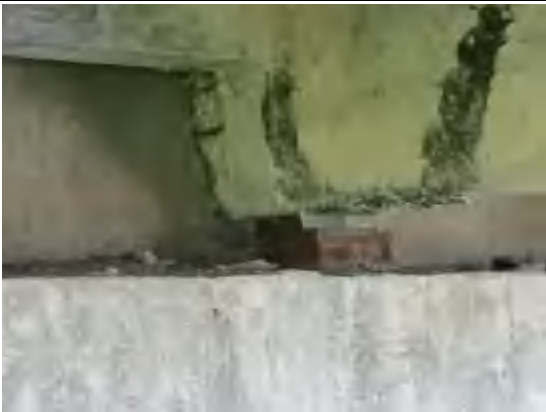
T 梁端头破损露筋
