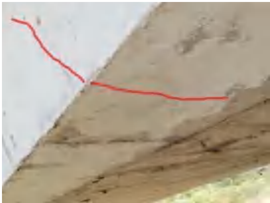
连续梁腹板与底部处横向裂缝
