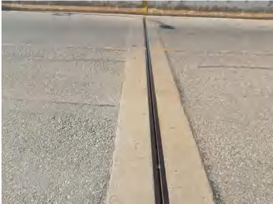
破损伸缩缝锚固砼横向裂缝
