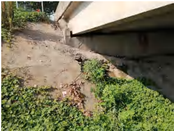
锥坡、护坡滋生杂植
