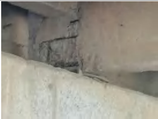
T 梁端部破损露筋
