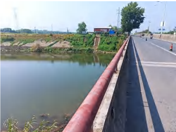
护栏钢扶手中度锈蚀
