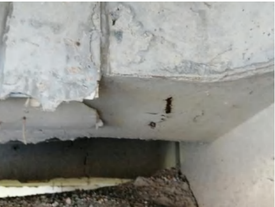
横隔板底面露筋
