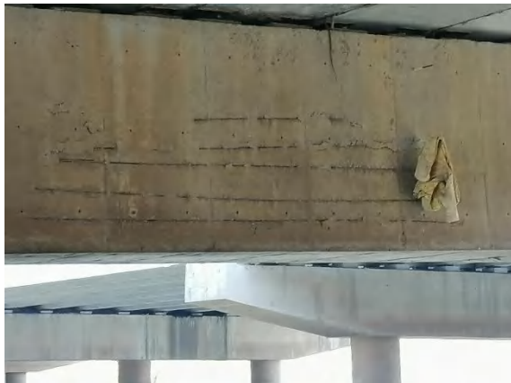
右中幅 5#盖梁锈胀
