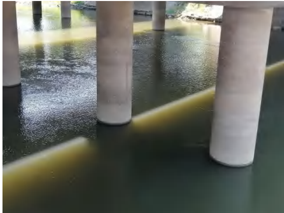
立柱冲刷、露骨
