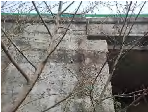
侧墙竖向开裂
