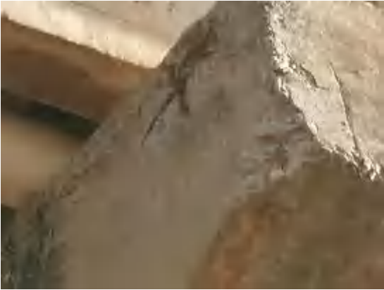
盖梁风化露筋破损
