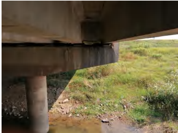
左幅 4#盖梁露筋
