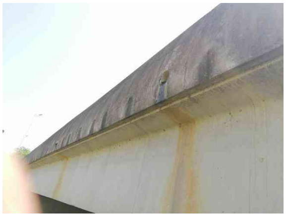
泄水管过短、雨水侵蚀梁体
