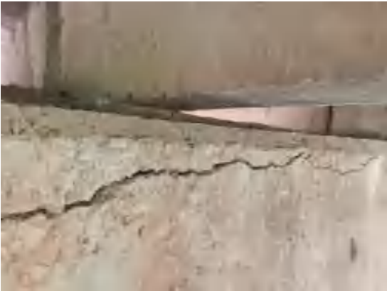
盖梁横向破裂
