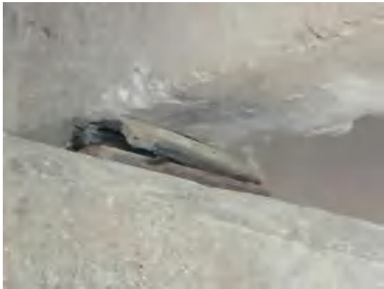
支座胶条断裂脱落
