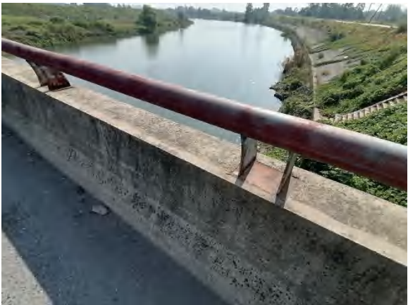
护栏钢扶手中度锈蚀
