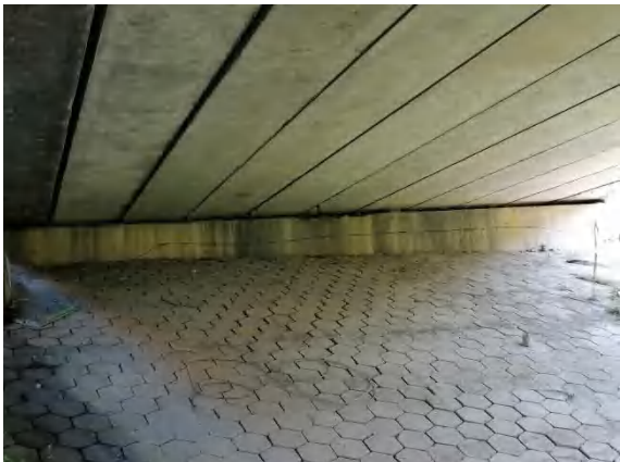
右幅 0#桥台盖梁渗水污染
