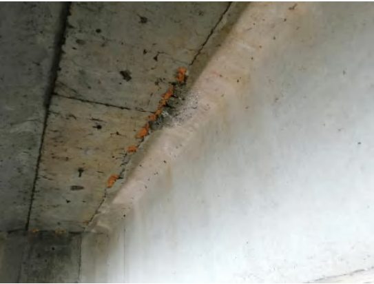
T 梁翼板混凝土破损
