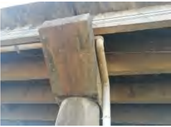
盖梁端部露筋
