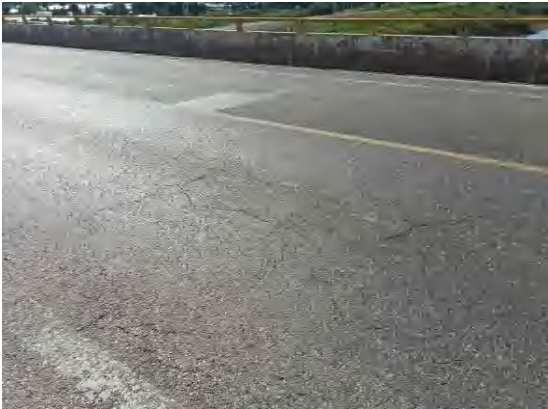
第 6 跨桥面网裂
