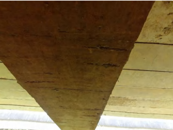
右中幅 1#盖梁底部露筋
