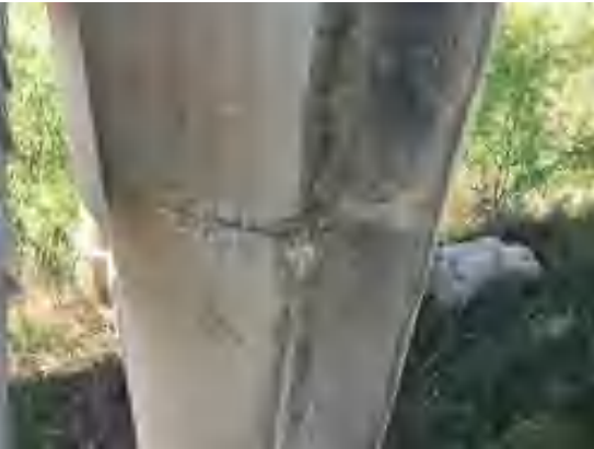
立柱破损露筋
