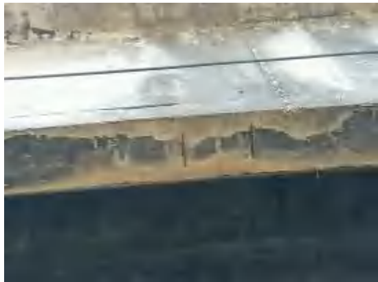
底板横向露筋
