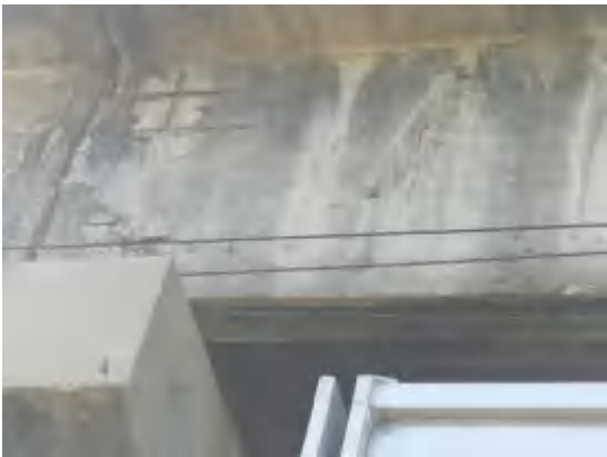
T 梁腹板锈胀露筋
