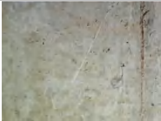
T 梁腹板竖向裂缝
