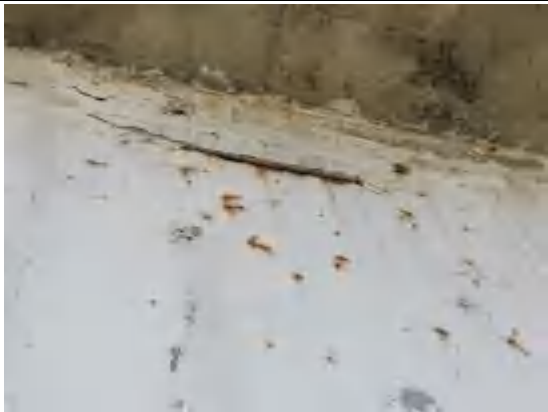
连续梁腹板锈胀露筋
